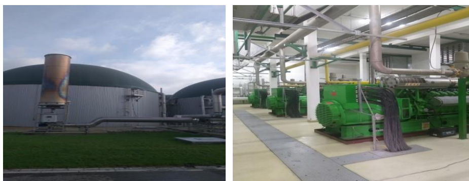
Сл. 8.2. Електрана Biogas Energy у Иланџи (лијево), генератор електричне енергије у фирми Biogas Energy (десно) (Фото Ракашћан Н)
